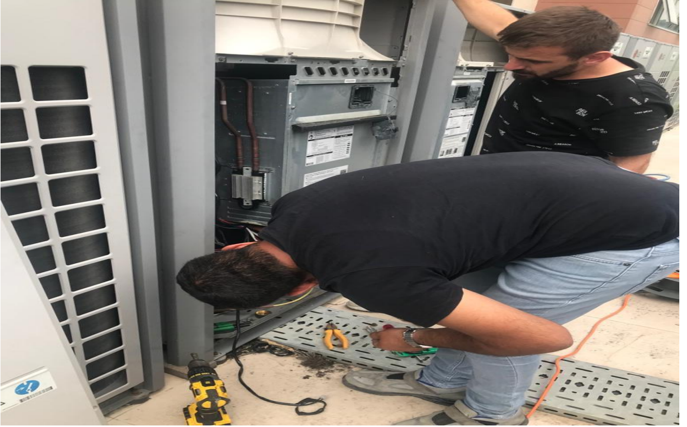
Fatsa Deniz Bilimleri Havalandırma Sistemleri Yapım İşı
